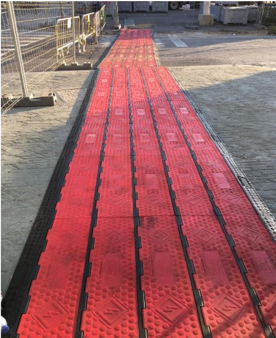
Ejemplo de unión entre este tipo de pasacables, no hay resaltes entre las uniones de pasacables.
